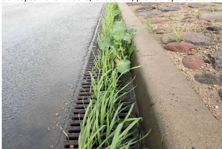
30. septembris. Bauska, Īslīces iela, pie LatRaps iebrauktuves. Rapsis un labība ceļa malā lietus notekūdens sistēmā. Paraugs 33.7.
