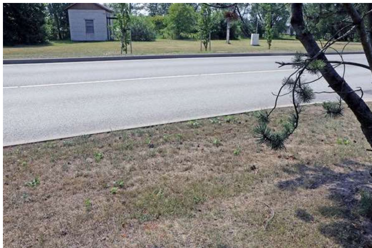
17. jūlijs. Ventspils, Kurzemes iela. Pievadceļš uz ostām "Grain Terminal", "Ventplac", uzņēmumu "BioVenta". Paraugi 10.3 – 10.4.
